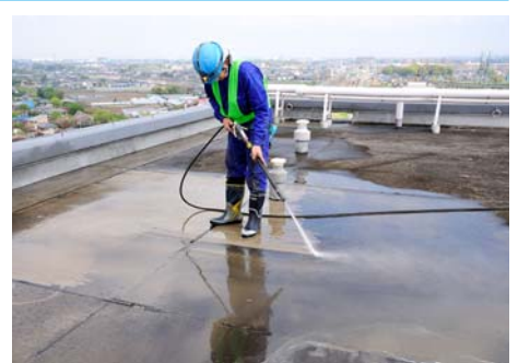
著しい汚れは漏水に配慮し、高圧水洗浄などで除去してください。
